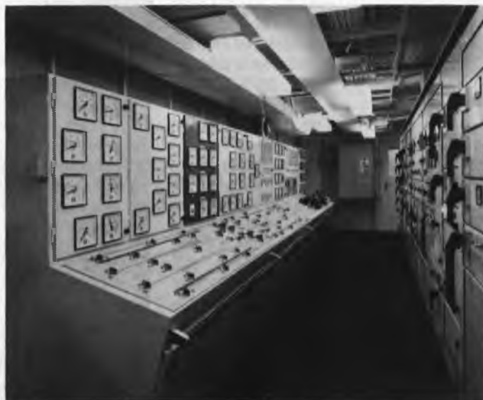
fig. 5. Bedieningspaneel en schakelbord machinekamer
