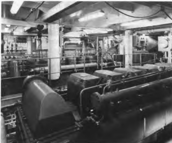
fig. 4. Machinekamer met twee 6 cilinder SWD TM 410 motoren, elk met een vermogen van 2950 kW (4000 pk)
