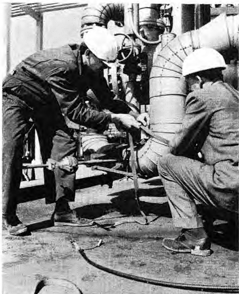
Fig. 12. Opstelling op een raffinaderij, waarbij het de bedoeling is om de conditie van een leiding-gedeelte te controleren zonder dat hierbij de isolatie van de pijp wordt verwijderd (on-stream inspectie)
